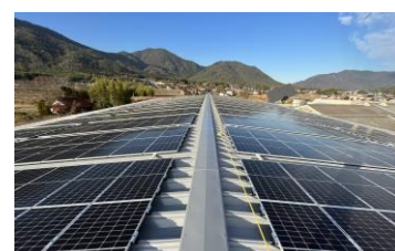
太陽光パネル
