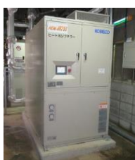
ヒートポンプ
